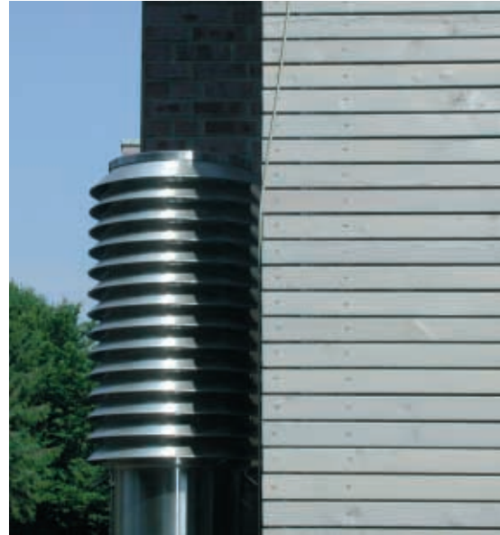
Schönheit eines Technik-Elements: der Edelstahl-Ansaugstutzen für die Lüftungsanlage sichtbar vor der Fassade aus Lärche-Holzverschalung.
