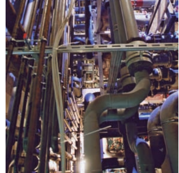
Gebäudetechnik im Bundestagsneubau Paul-Löbe-Haus
